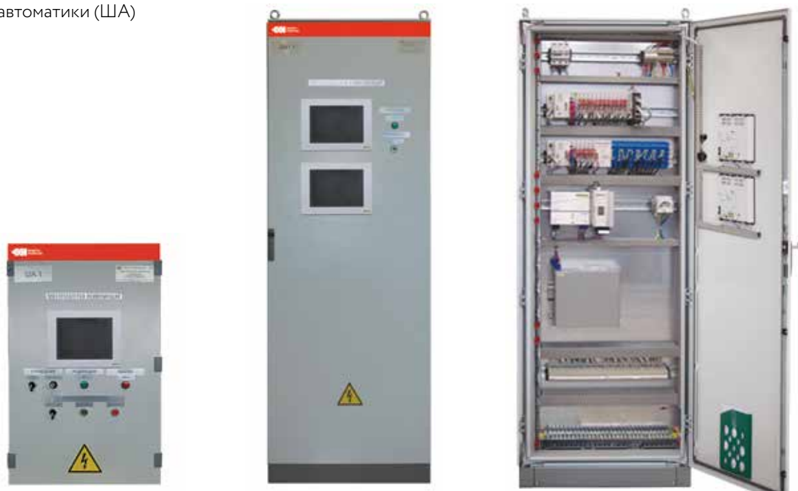
Шкаф автоматики (ША)
